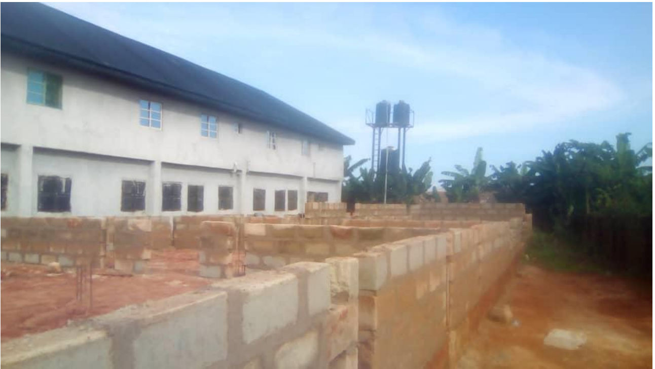
Der Bau des Internats befindet sich im April noch im Grundstadium. Neben der Schule sieht man im Hintergrund die Trinkwasserbehälter der Schule.
